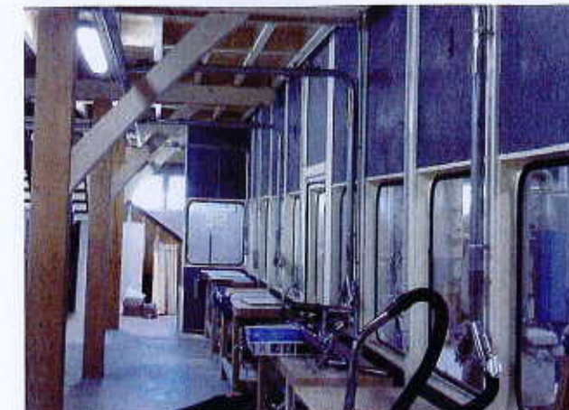
Dans cette salle de montage, l'installation « haute dépression » a été étudiée pour le branchement d'outils portatifs.
