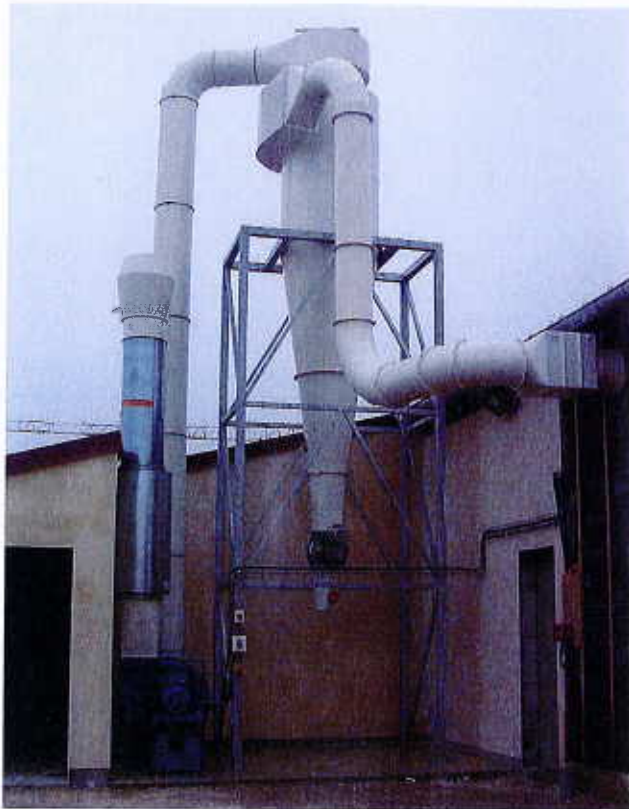
Système de dépollution et d'aspiration centralisée haute dépression conforme aux directives ATEX.
