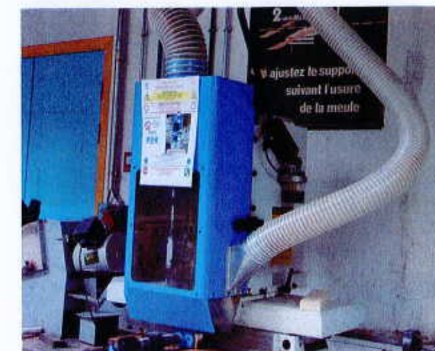
L'encoffrement des machines est la meilleure solution pour le captage direct des poussières au plus près de la source d'émission.
