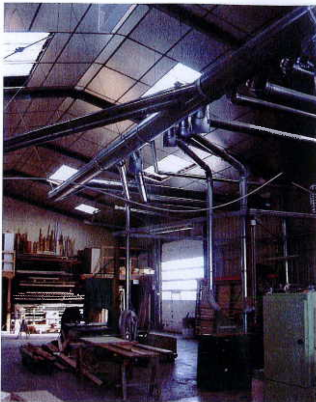
Installation classique de tuyauterie métallique en arborescence au plafond, dans un atelier de menuiserie.
