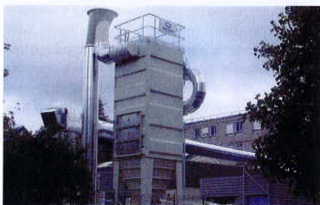
Remarquez, sur le côté de cette centrale de dépollution, les trois événements (volets) destinés à éviter la propagation d'une explosion.
