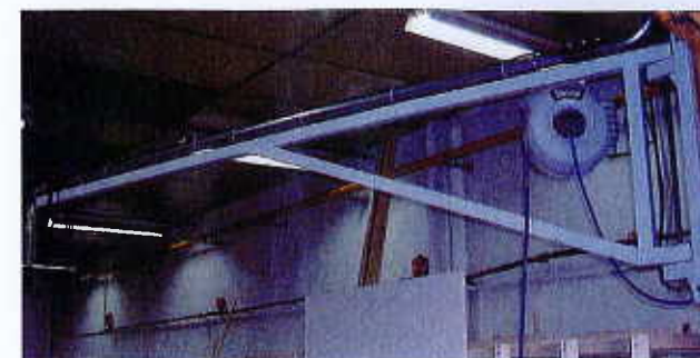
Dans un atelier, on ne pense pas assez à la potence. Il s'agit pourtant d'un système peu encombrant qui permet de couvrir une large surface.
