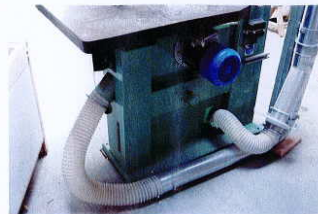
Récupération des sciures sur une scie à ruban au niveau du volant et du fond de carter.
