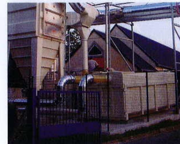
Récupération centralisée des déchets par benne.
