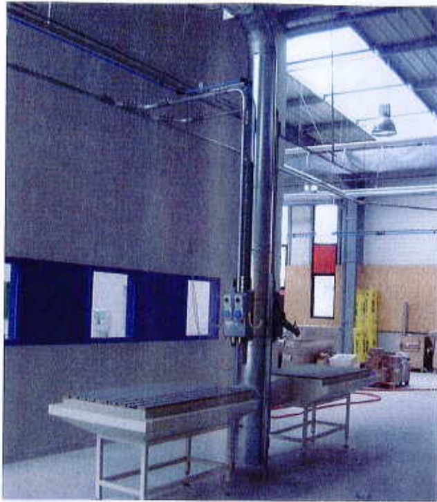
Un bel exemple d'installation de tables de ponçage.
