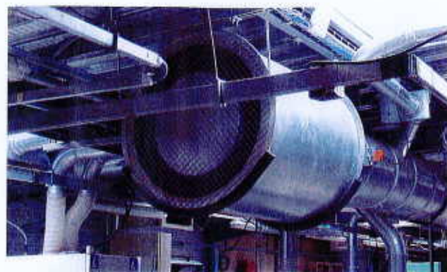
Impressionnante prise d'air d'installation avec régulation.
