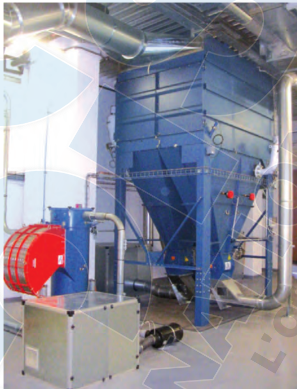
Vue d'ensemble sur le local contenant les dépoussiéreurs à la Cité du Cinéma.
