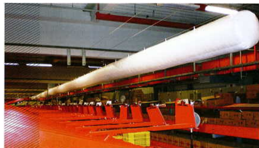
Les débits minimaux s'appliquent à de l'air neuf pris directement sur l'extérieur sans transiter dans d'autres locaux
