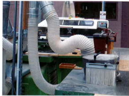
Captage à la source de poussières de bois sur un poste de travail dans un atelier.
